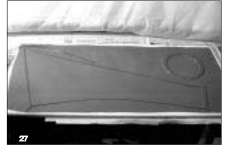
Nach Papierschablonen werden Leisten für den Klapptriebwerksschacht, bestehend aus Spant und Trennwand, auf eine Spanplatte geklebt und mit Vakuum eine Folie darüber gezogen.
